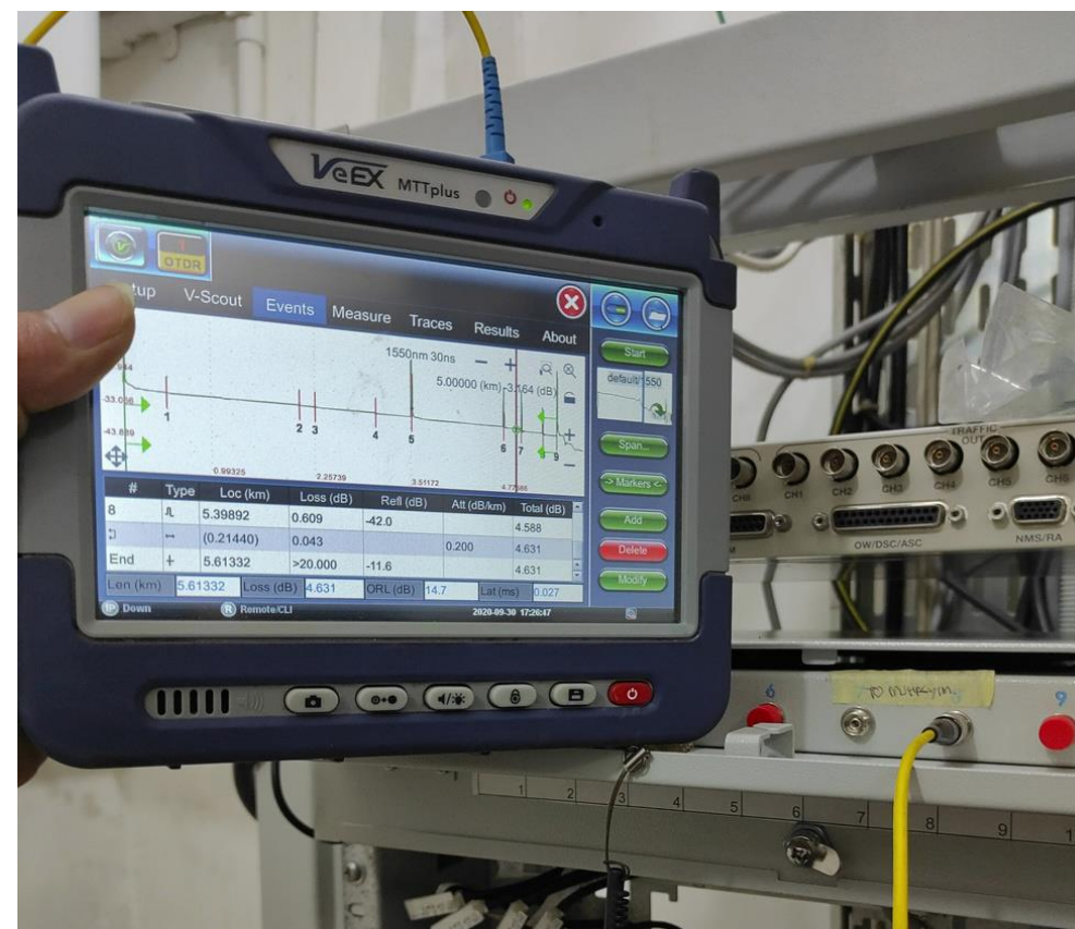
Pengukuran Ujung ke Ujung Kabel Fiber Optik
